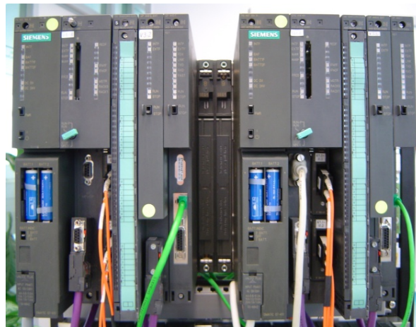
نمایی از SIEMENS Redundant CPU's
